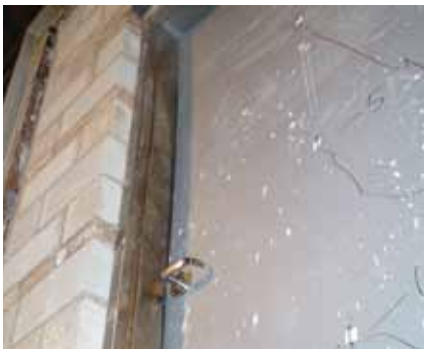
5. Heat sensors on door
